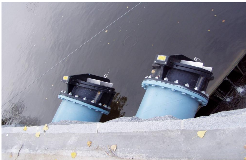
Obr. 8/2 Klapkové uzávěry na vyústění potrubí do toku
