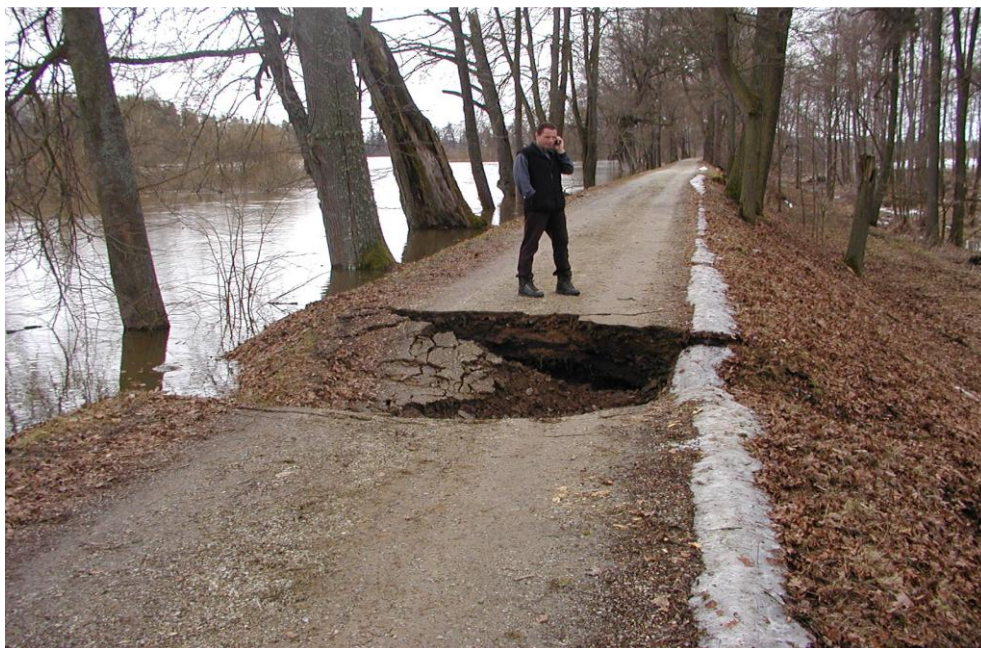
Obr. 6/1 Ochranná levobřežní hráz umělého vodního toku Nová řeka, poruch hráže a její provizorní sanace pytli s pískem
