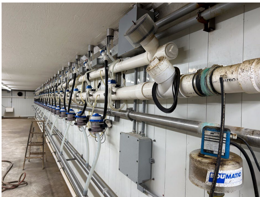
Obrázek 2.94: Zázemí pro část technologie dojení v prostoru pod dojící uličkou
