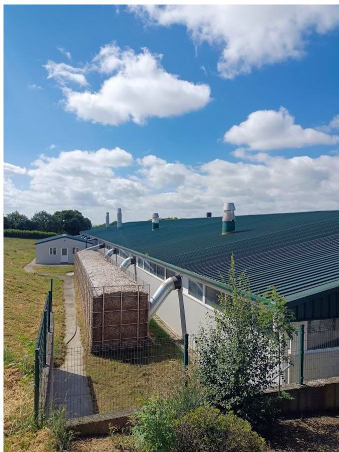
Obrázek 2.21: Část střešní ventilace byla zrušena a svedena do biofiltrů
