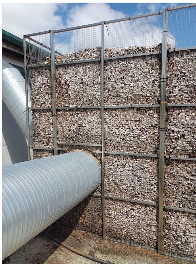
Obrázek 2.23: Detailní pohled na provedení biofiltru
