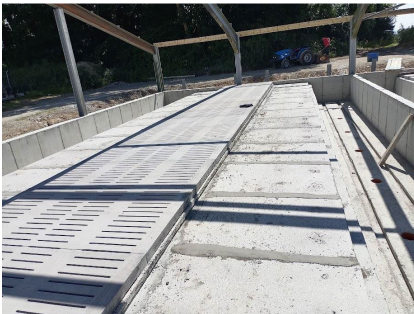
Obrázek 2.42: Obslužná ulička a prostor pro krmení tvoří roštová podlaha z betonu
