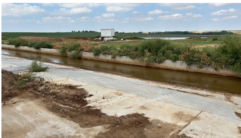
Obrázek 2.100: Kanál pro odvod proplachovací vody s výhledem na budovu separátoru, plochu pro skladování separátu a lagunu
