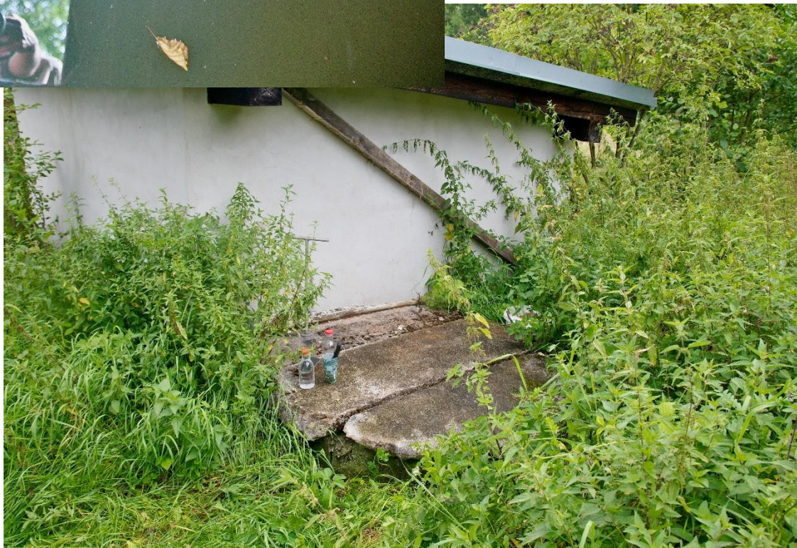
studna se zaústěním vod z průmyslového areálu
