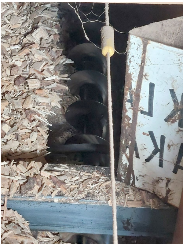
Fotografie č. 9: Šnekový dopravník zajišťující přesun dřevní štěpky ze skladu do kotle.
