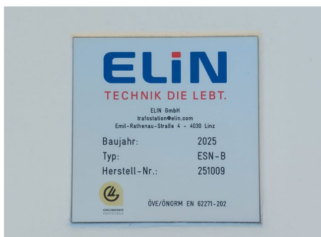
Fotografie č. 32: Výrobní štítek trafostanice instalované v rámci projektu Agri-PV Mauthausen.
