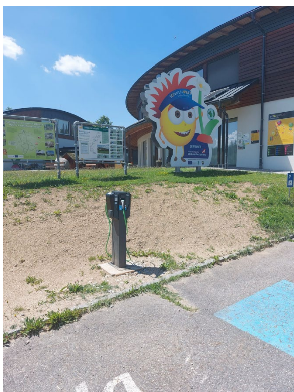
Fotografie č. 14: Nabíjecí stanice pro elektromobily umístěná před vstupem do centra Sonnenwelt Großschönau.
