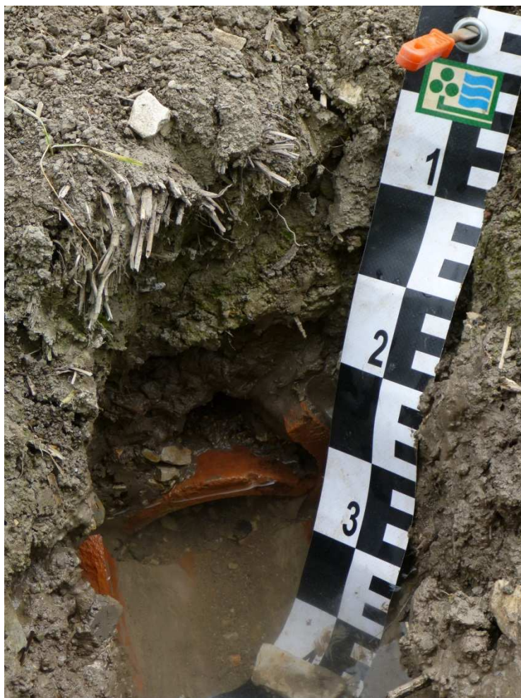
Foto 9.29: Porušené drenážní potrubí na pozemku č. 12 (22. 5. 2013)
