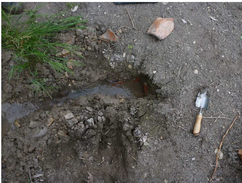
Foto 9.30: Porušené odvodňovací zařízení na pozemku č. 12 (22. 5. 2013)
