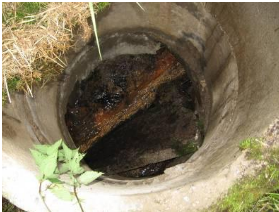
Obr. č. 12: Drenážní šachtice (zanedbaná údržba, zakleslá hladina podzemní vody)
