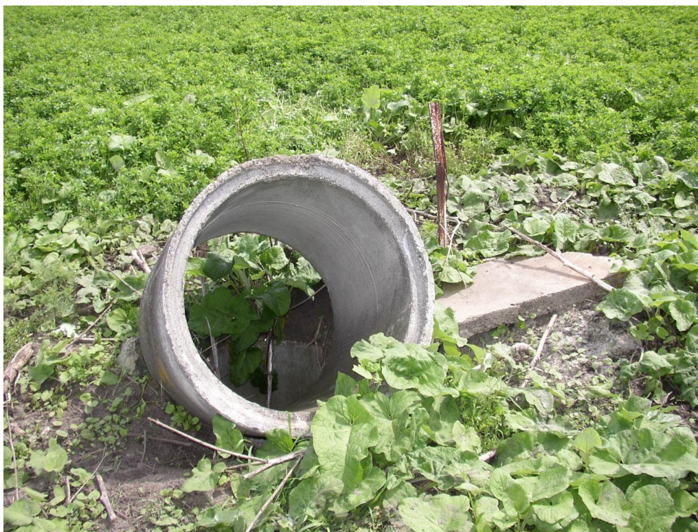
Obr. č. 15: V mnoha případech odvodňovací soustava vypadá dnes takto
