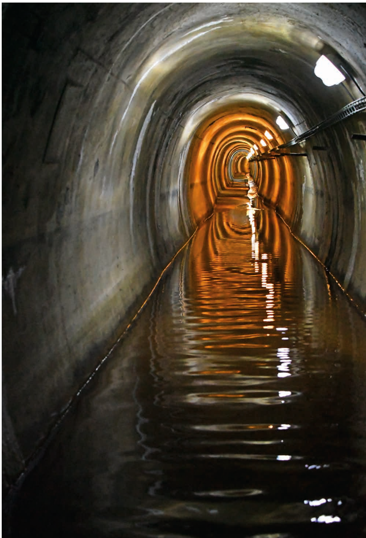
Odvodňovací štola VD Josefův Důl (zdroj: Povodí Labe)
