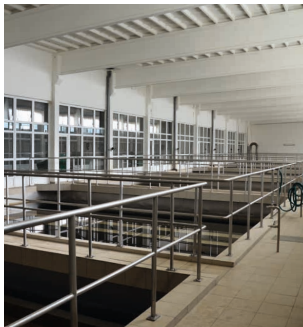
Úprava vody Káraný (autor Martin Mareš)
