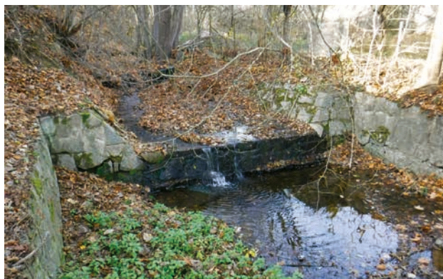
Nihošovický potok, Nihošovice – před opravou regulace (zdroj: Povodí Vltavy)
