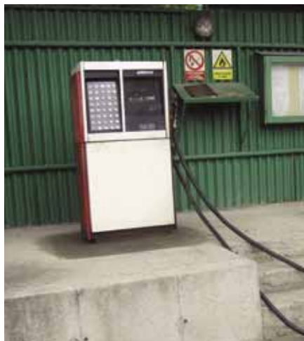
Čerpací stanice pohonných hmot vhodně zabezpečená proti únikům ropných látek i vlivu srážkových vod.
