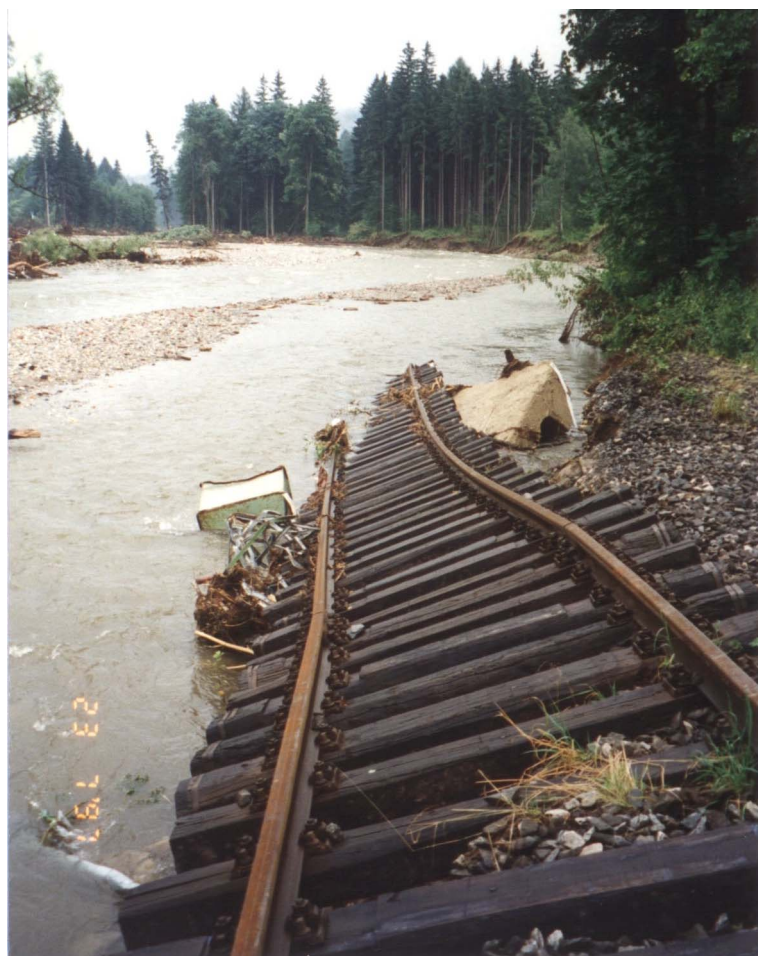
Foto 19: Trať Vrbno pod Pradědem – Krnov po povodni v červenci 1997 (1) Povodněmi je ohrožována i dopravní infrastruktura v údolí.
