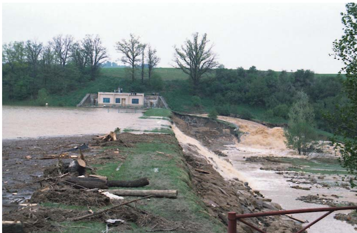
Foto 23: Čížina, nádrž Pocheň, poškození za povodně v květnu 1996 Jsou zaznamenány případy, kdy za extrémních povodní došlo k i ohrožení bezpečnosti vodních děl.
