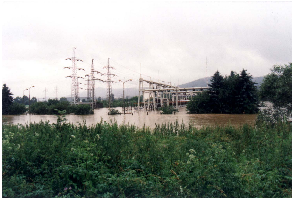
Foto 6: Povodeň 1997, Krnov Povodní byla zasažena i životně důležitá infrastruktura města (na snímku rozvodna energetické sítě).
