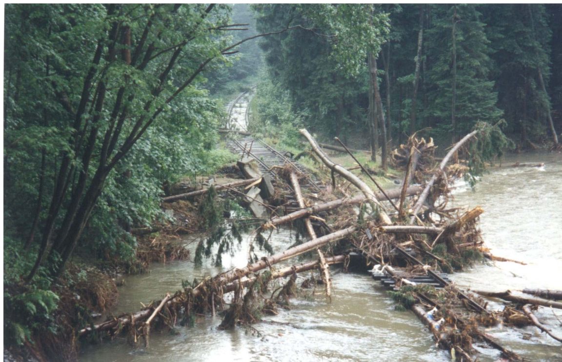
Foto 20: Trať Vrbno pod Pradědem – Krnov po povodni v červenci 1997 (2) Zničení železniční tratě.
