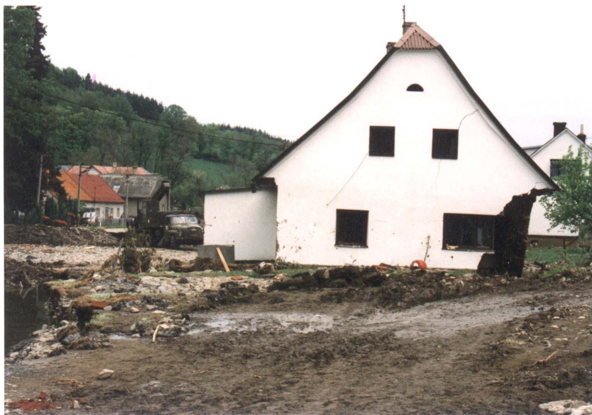
Foto 18: Čížina, obec Lichnov po povodni v květnu 1996 K destrukci obytných budov převážně dochází v důsledku obtékání jejich obrysů a podemíláním jejich rohů.
