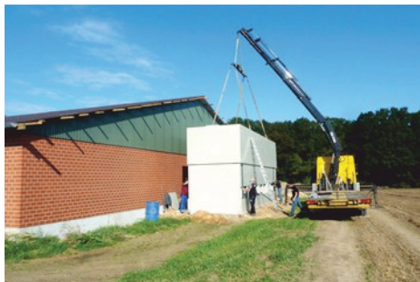
Obrázek 6 – Instalace technologie biologické pračky vzduchu od společnosti Möller, s.r.o.
