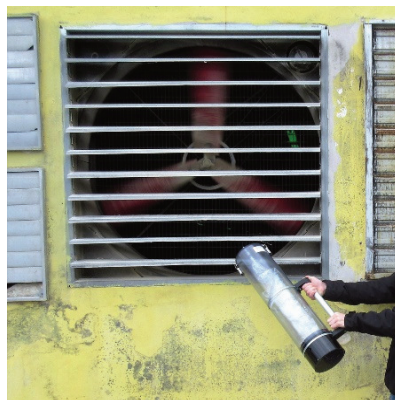
Obrázek 14 – Odváděný vzduch z objektu (odebraný vzduch) je nasáván před žaluzií větrací šachty odsávacího ventilátoru na vnější straně objektu
