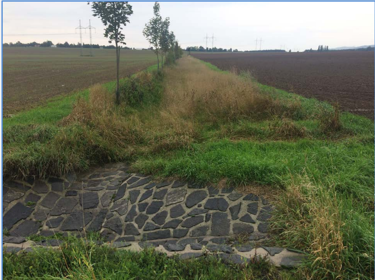
Průleh s odvedením vod trubním kanálem do VT
