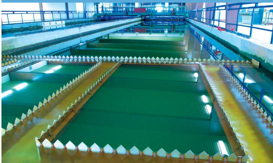
Štítary úpravna vody
