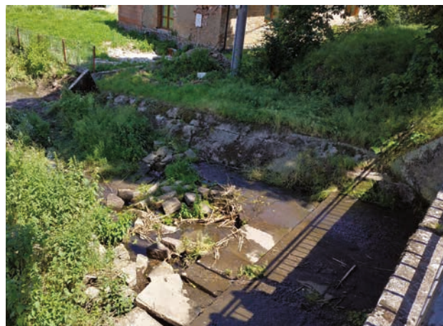
Příchovický Stream, Horšice, reinforcement before repair (Source: Vltava River Board)
